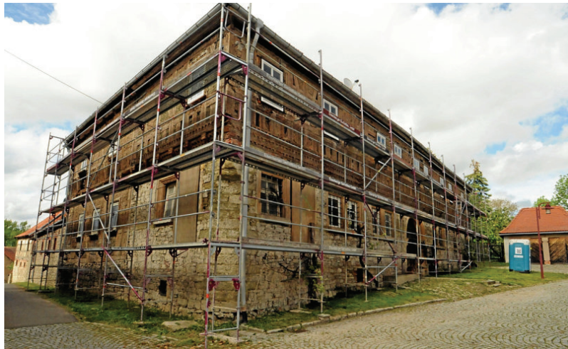
Vom Putz befreit zeigt die Fassade jetzt ein eindrucksvolles Fachwerk, das erhalten und freigelegt werden soll.
